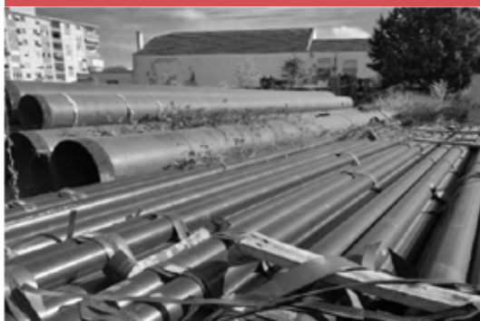
Цевки за изградба на дистрибутивната мрежа за природен гас и затварање на прстенот околу Скопје
