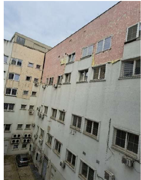
Слика број 5 – Оштетена фасада на зградата на АД МЕПСО Скопје
