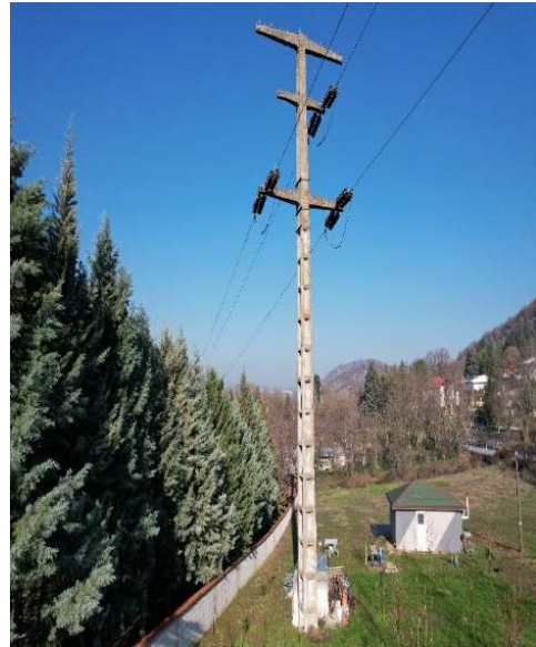
Слика бр. 4– Столб од постојниот "110kV ДВ ТС Скопје 4-ТС Велес" кој требало да се реконструира
