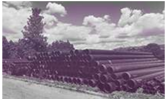
Набавени цевки за изградба на дистрибутивна мрежа за пренос на природен гас-прстен Град Скопје
