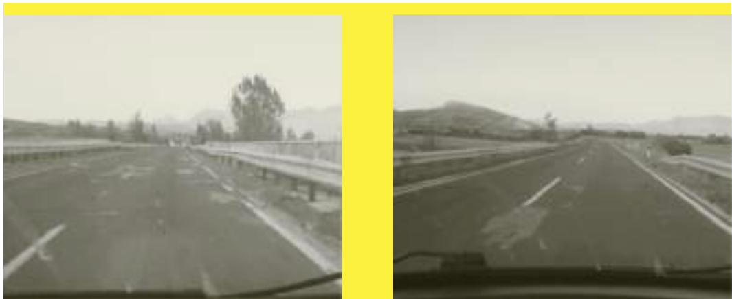
FOTOGRAFIA NUMËR 1 - DËMTIMET FIZIKE DHE MIRËMBAJTJA E DOBËT E RRUGËS
