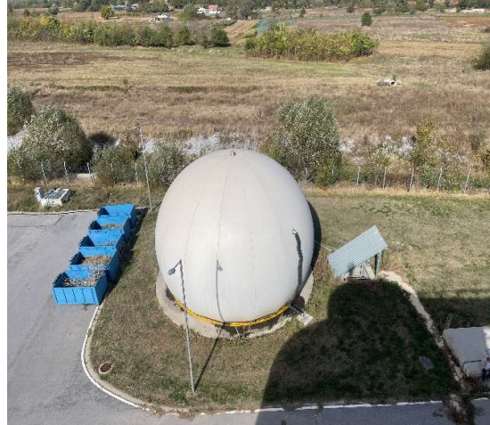
резервоар за складирање на метан
